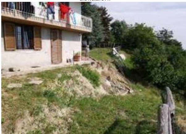
Novello, San Grato. Scivolamento rotazionale a valle di un'abitazione, probabilmente a carico di terreno di riporto
