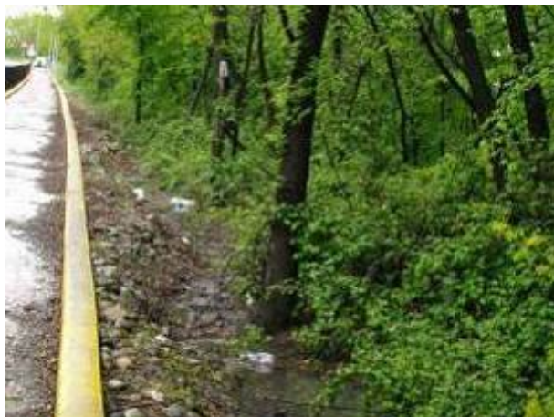
Dissesto lungo la strada provinciale
