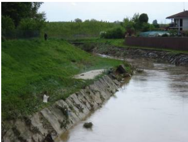
Vista del T. Banna (lato di monte) dal ponte di Via Cavour a Santena. In destra visibile l'erosione del rivestimento in lastre di calcestruzzo
