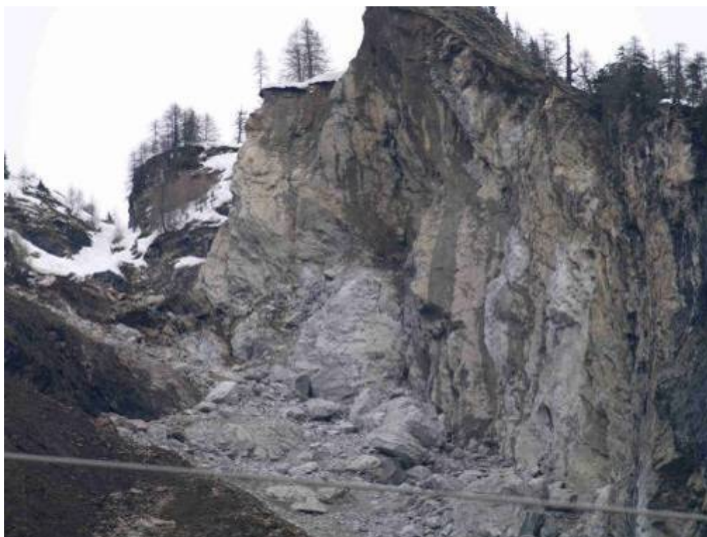
Zona di distacco: si osservano pessime condizioni strutturali e meccaniche dell'ammasso roccioso
