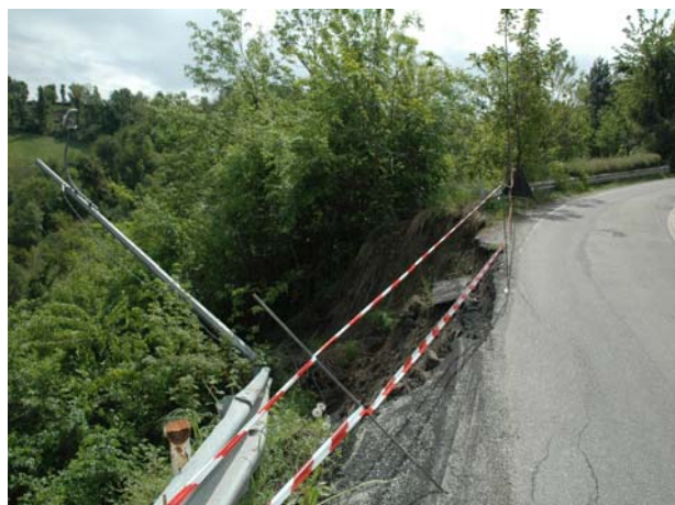
Cedimento della sottoscarpa con danneggiamento della sede stradale e dell'impianto di illuminazione, lungo la strada per loc. T.ti Varetto, Castiglione T.se
