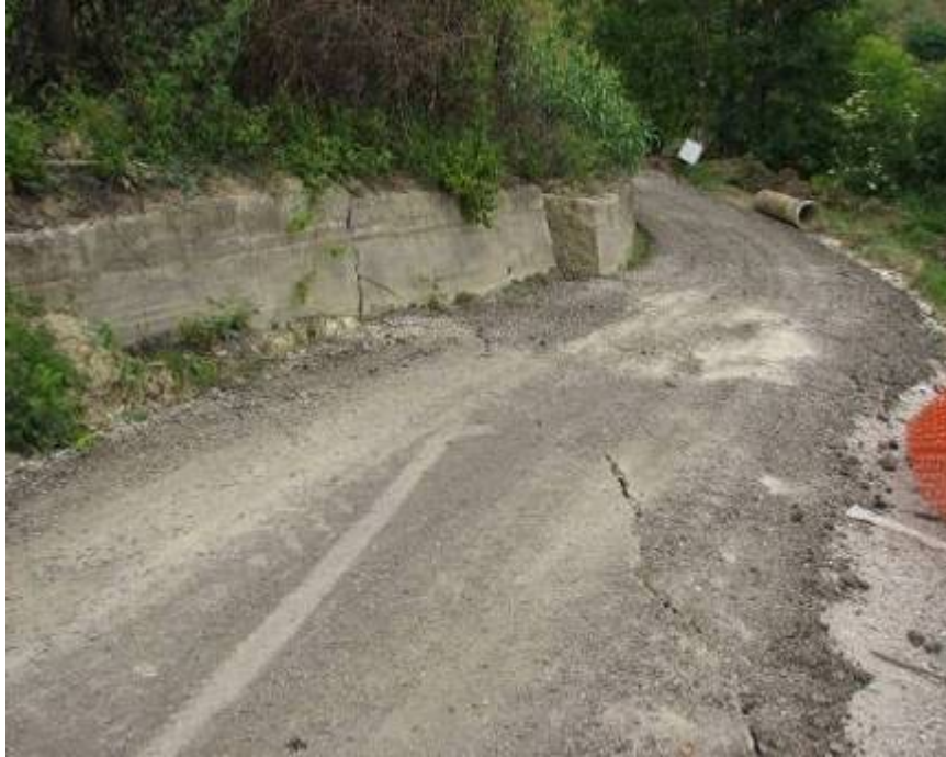
Comune di Nizza Monferrato: frana lungo la strada per località Rinaldi. Strada danneggiata.
