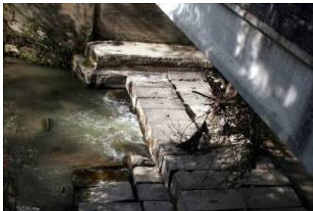
Soglia sottoscavata dalle acque che, invece di scorrere sopra di essa, scorrono al di sotto.
