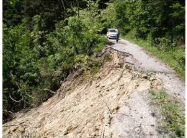
Bossolasco, strada Bicocca-San Nicola. Scivolamento rotazionale evolutosi in colamento veloce, ai danni della carreggiata stradale
