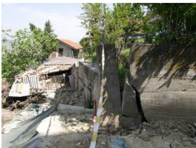
Danni alle pertinenze della 3a abitazione
