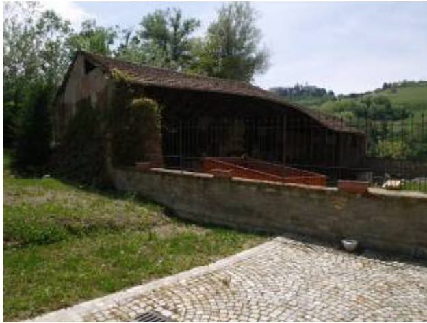
Rodello, C. Spessa. Scivolamento planare. Il piede del movimento si è arrestato a pochi metri dall'abitazione e ha gravemente danneggiato il porticato
