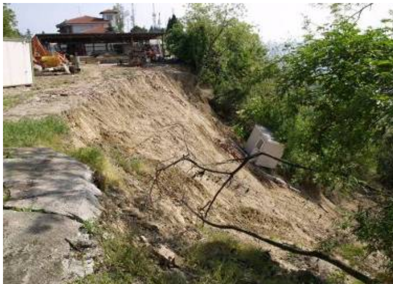
Particolare del cortile coinvolto dal franamento, posto sul retro degli edifici
