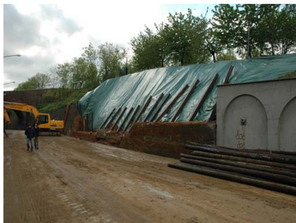
Cedimento del muro in Corso Bruno Buozzi, Chieri, situazione dopo lo sgombero del materiale
