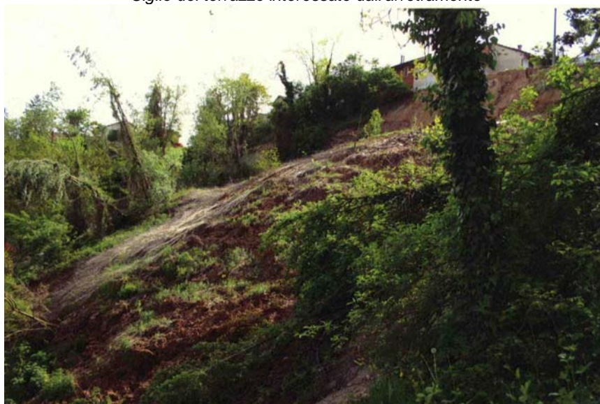
Corpo di frana
