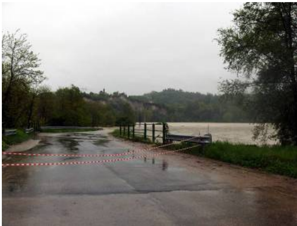
Torrente Borbore ad Asti, strada per Vaglierano, ponte sul Rio dei Mulini sormontato dalla piena. (foto Di Martino del 27/04/2009)
