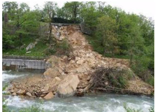
Montaldo di Mondovì, Corsagliola. Scivolamento rotazionale originatosi sulla strada di fondovalle per Corsaglia; mezza carreggiata è stata asportata
