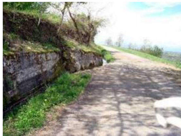
Strada comunale di Montechiaro con dislocazione di circa 70 cm del muro di controripa
