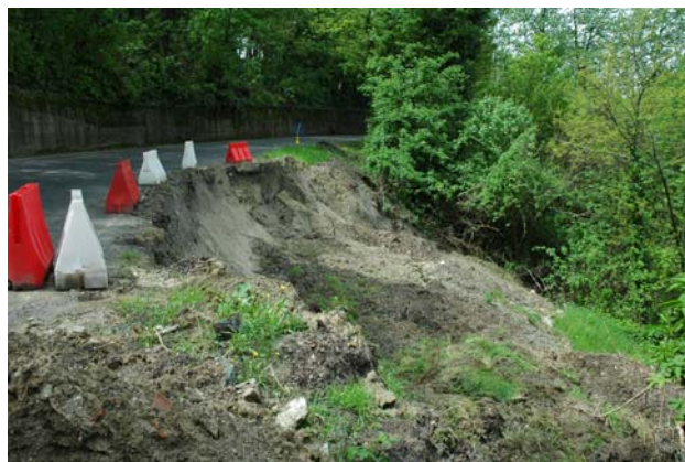
Cedimento sul fianco esterno della sede stradale, Gassino SP 118 di Sciolze, il dissesto ha causato la riduzione della viabilità
