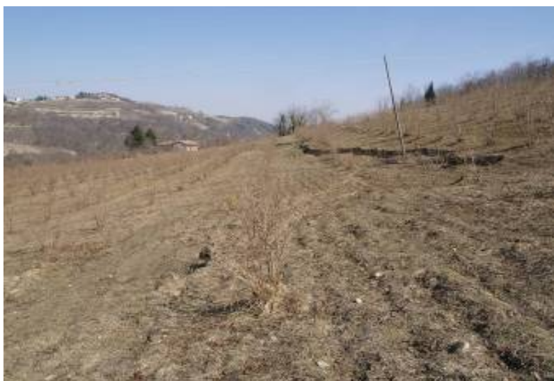
Coronamento di frana, situazione del 17 marzo 2009. La fotografia è stata scattata dal fianco sinistro guardando verso nord-est
