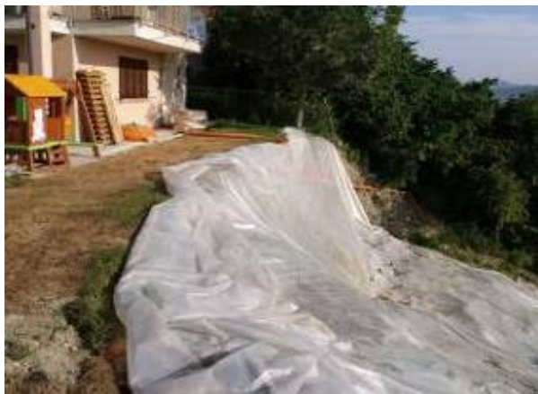
Novello, c. Barlotto. Scivolamento rotazionale con nicchia di distacco immediatamente a valle di due abitazioni
