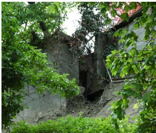
Cedimento parziale del muro di recinzione di un'abitazione privata, Sciolze
