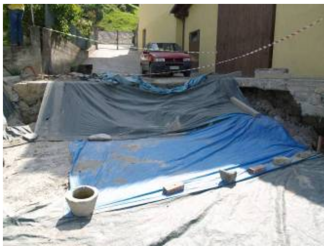
Danni alle pertinenze della 2a abitazione
