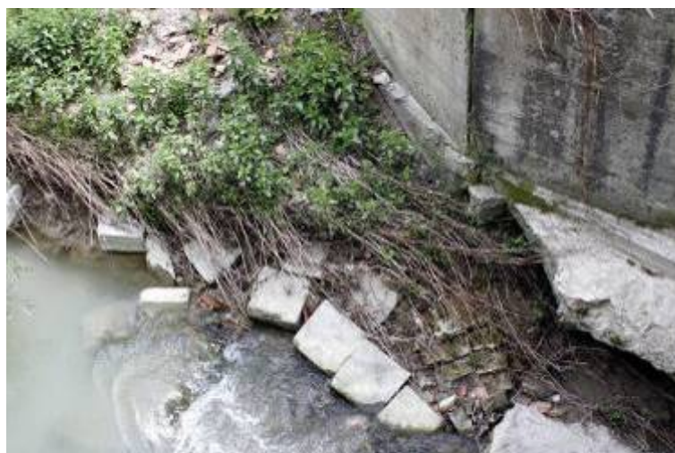
Fenomeni di erosione di fondo del torrente Versa a danno del ponticello per il Mulino Galla (Castell'Alfero). Particolare della spalla sinistra.
