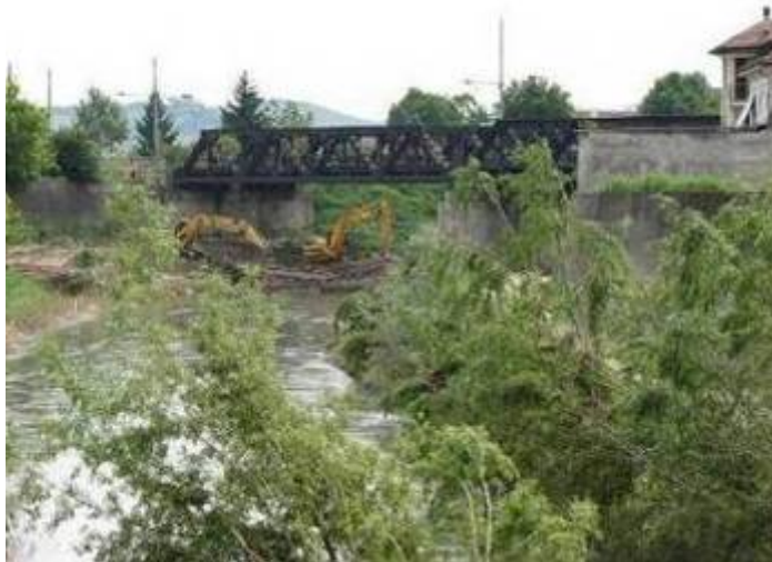
Ponte ferroviario di Nizza Monferrato: Tronchi e resti vegetali si sono accumulati in prossimità dell'opera.
