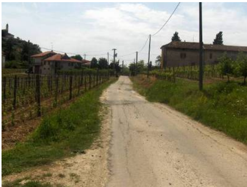
Comune di San Marzano Oliveto - Fenomeno di dissesto in loc. Font.na Bonada
