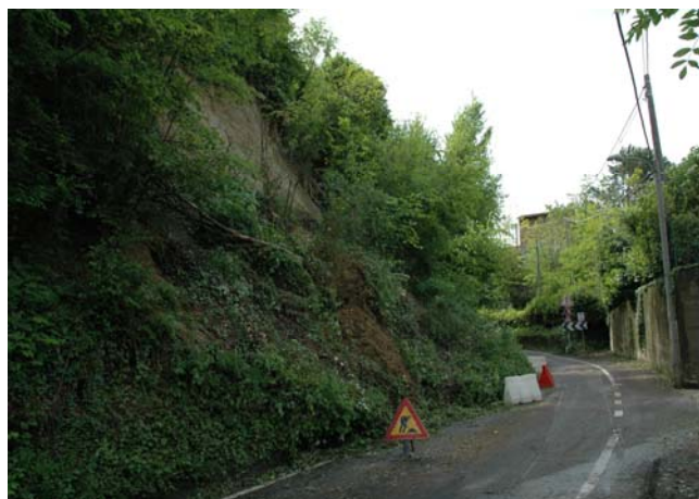
Cedimento della scarpata lungo la strada per loc. S. Martino, Castiglione T.se
