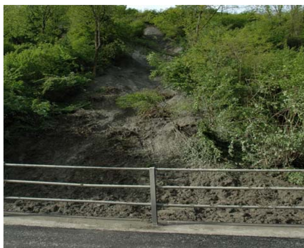
Colamento rapido in strada Cartman, Torino, il materiale ha parzialmente ostruito il corso d'acqua
