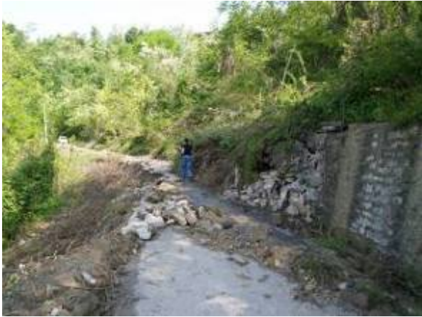
Castellino Tanaro, Maccaferro. Scivolamento rotazionale evolutosi in colamento veloce. La strada è stata ostruita dal terreno franato ed è a sua volta franato sul lato di valle
