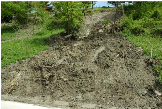
Colamento di terra e materiale vegetale in corrispondenza di loc. Vernone, Sciolze
