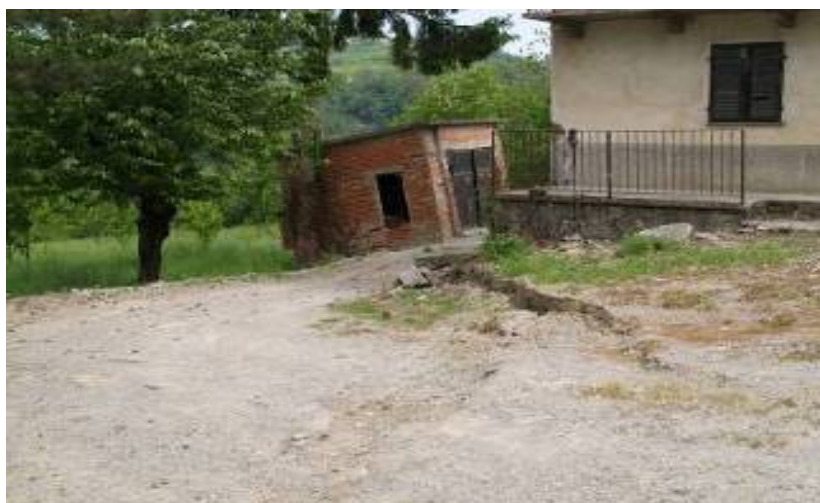
Danni al fabbricato adibito a rimessa e fratture nel piazzale, situazione del 4 giugno 2009
