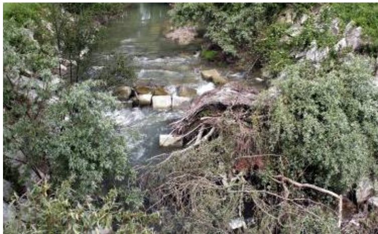
Stato delle opere di sistemazione idraulica lungo un tratto del torrente Versa: quello che era l'antico rivestimento in blocchi di cemento è stato completamente disarticolato dal susseguirsi delle piene.
