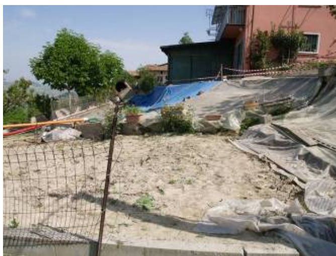
Danni al giardino della 4ª abitazione
