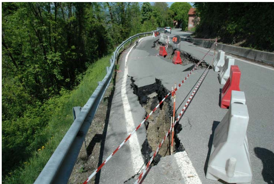
Cedimento della carreggiata lungo la Strada Provinciale n° 97 di Cinzano
