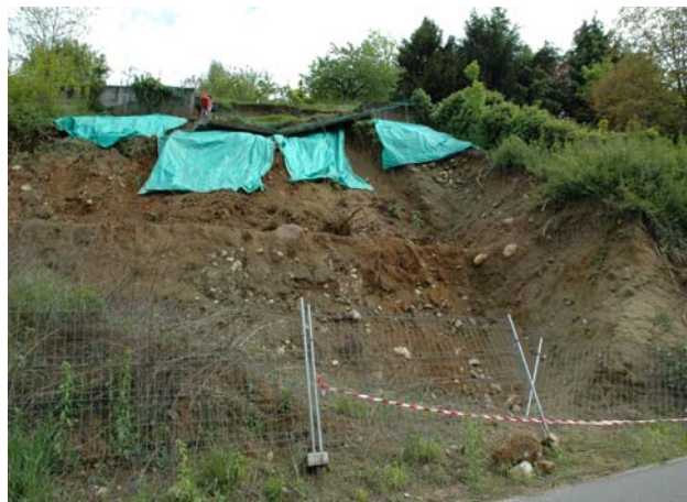
Colamento in località Tetti Trivero, Baldissero Torinese, situazione dopo le piogge del 26-28 aprile 2009, la strada è stata chiusa al traffico in via precauzionale
