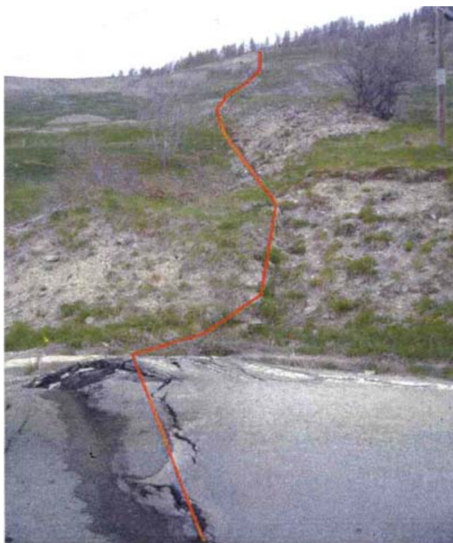
Danni alla viabilità comunale in corrispondenza del margine orientale del movimento franoso
