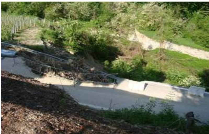
La frana vista dall'alto (cimitero)
