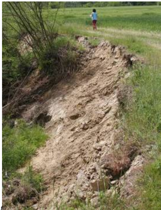
Tigliole, a monte del ponte sulla SP12b. Esempio di instabilità delle sponde causato da erosioni al piede per tendenza all'approfondimento del fondo-alveo.
