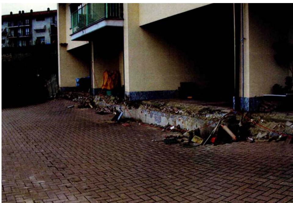
Edificio e piazzale antistante interessati dal movimento franoso
